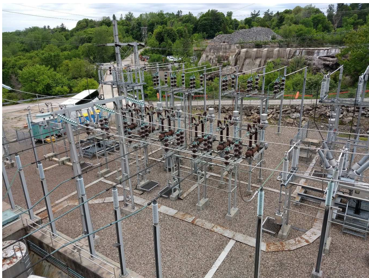
Рисунок 11 – Распределительное устройство высокого напряжения ГЭС
