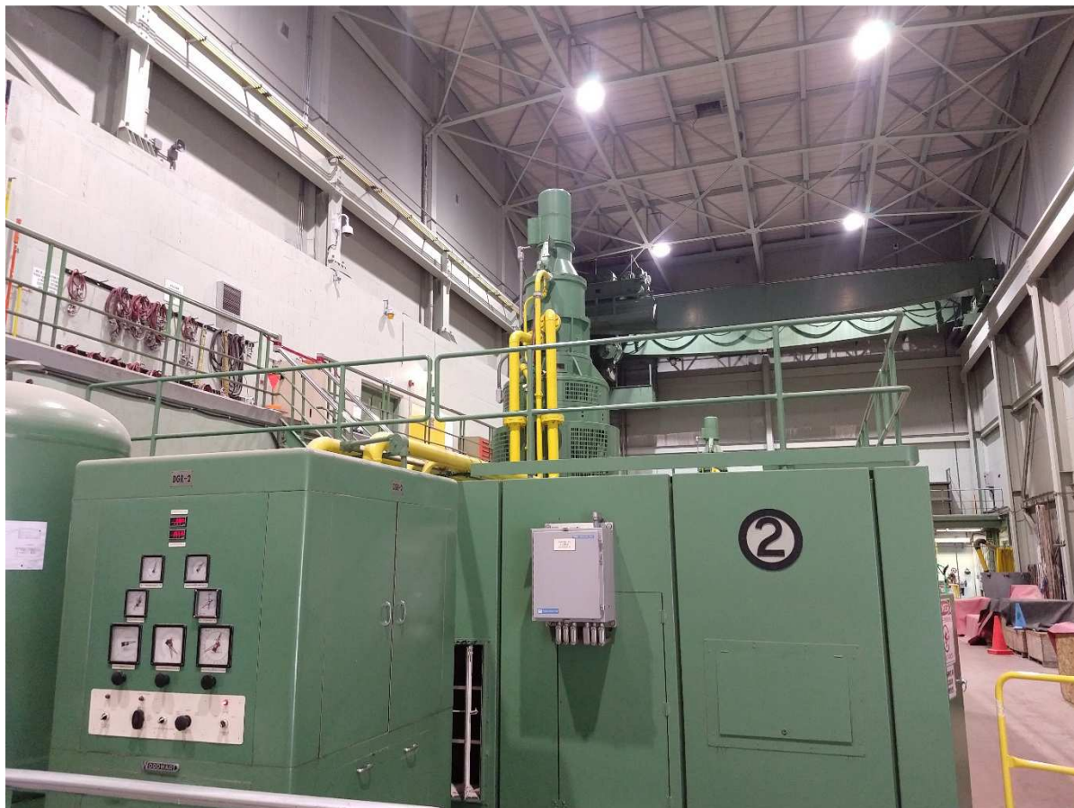
Рисунок 10 – Машинный зал ГЭС
